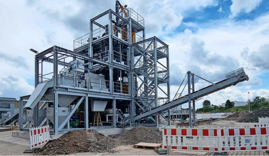
Diese Aufbereitungsanlage bestehend aus 12 Containereinheiten umfasst alle wichtigen Apparate, die für ein hocheffizientes Recycling von Mineralien erforderlich sind
